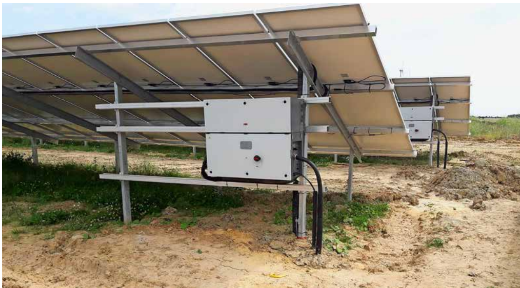
Wechselrichter unter einem PV-Modul.
