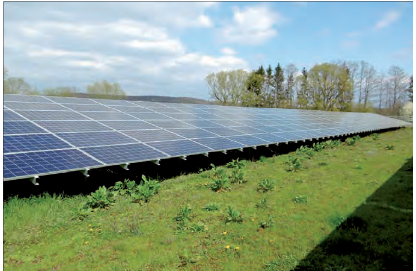
Die neu in Betrieb genommene PV-Anlage in der Gemeinde Katlenburg-Lindau hat eine Grundfläche von rd. 1,8 ha
