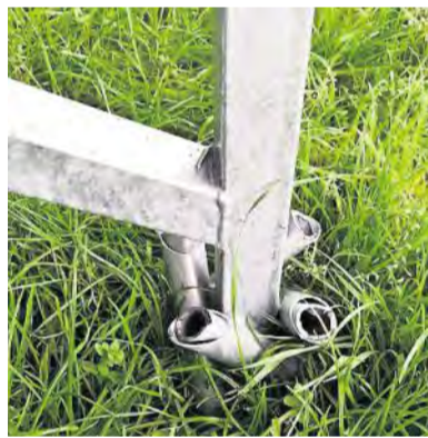
Die Photovoltaik-Anlagen wurden besonders sicher verankert.
