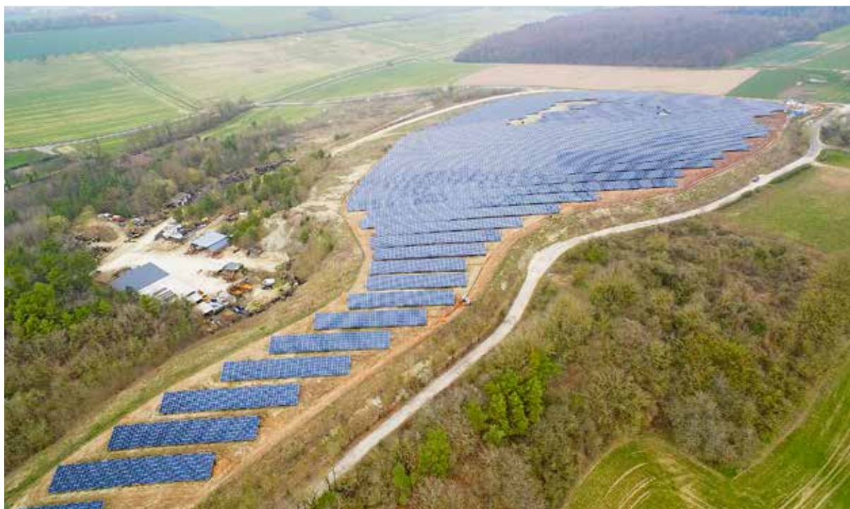
Blick von oben: Der Solarpark der Firma WI Energy bei Kersch ist so groß wie etwa sechs Fußballfelder. FOTOS (2): WI ENERGY
