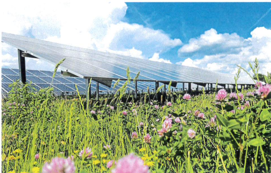
Eine Anlage der WI Energy in Kattenburg.
